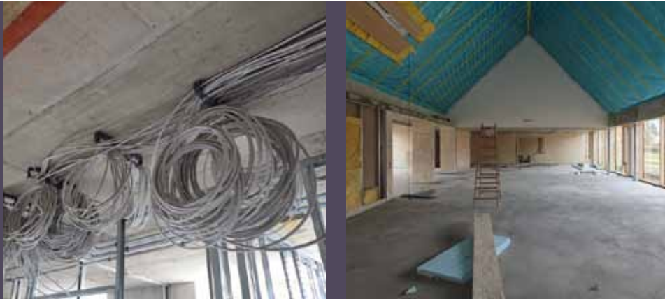
In unserem Gemeindehaus wurden hunderte Meter Kabel verlegt (l.) und das Dach nach neuesten energetischen Standards gedämmt (r.)
